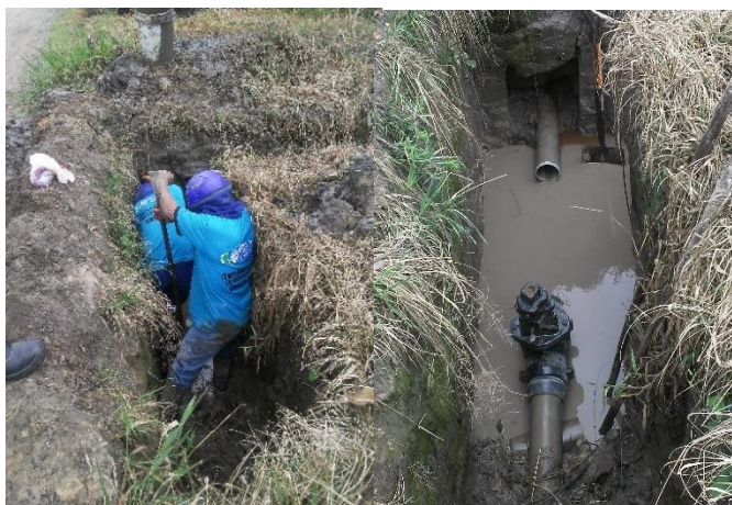
MANTENIMIENTO DE LLAVE DE CONTROL DE LA RED DE DISTRIBUCIÓN
