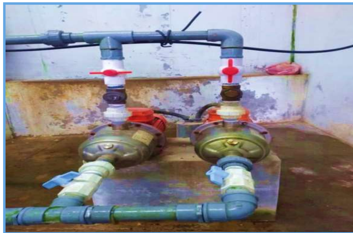
BOMBAS BOSSTER PARA SISTEMA DE INYECCION AL VACIO
