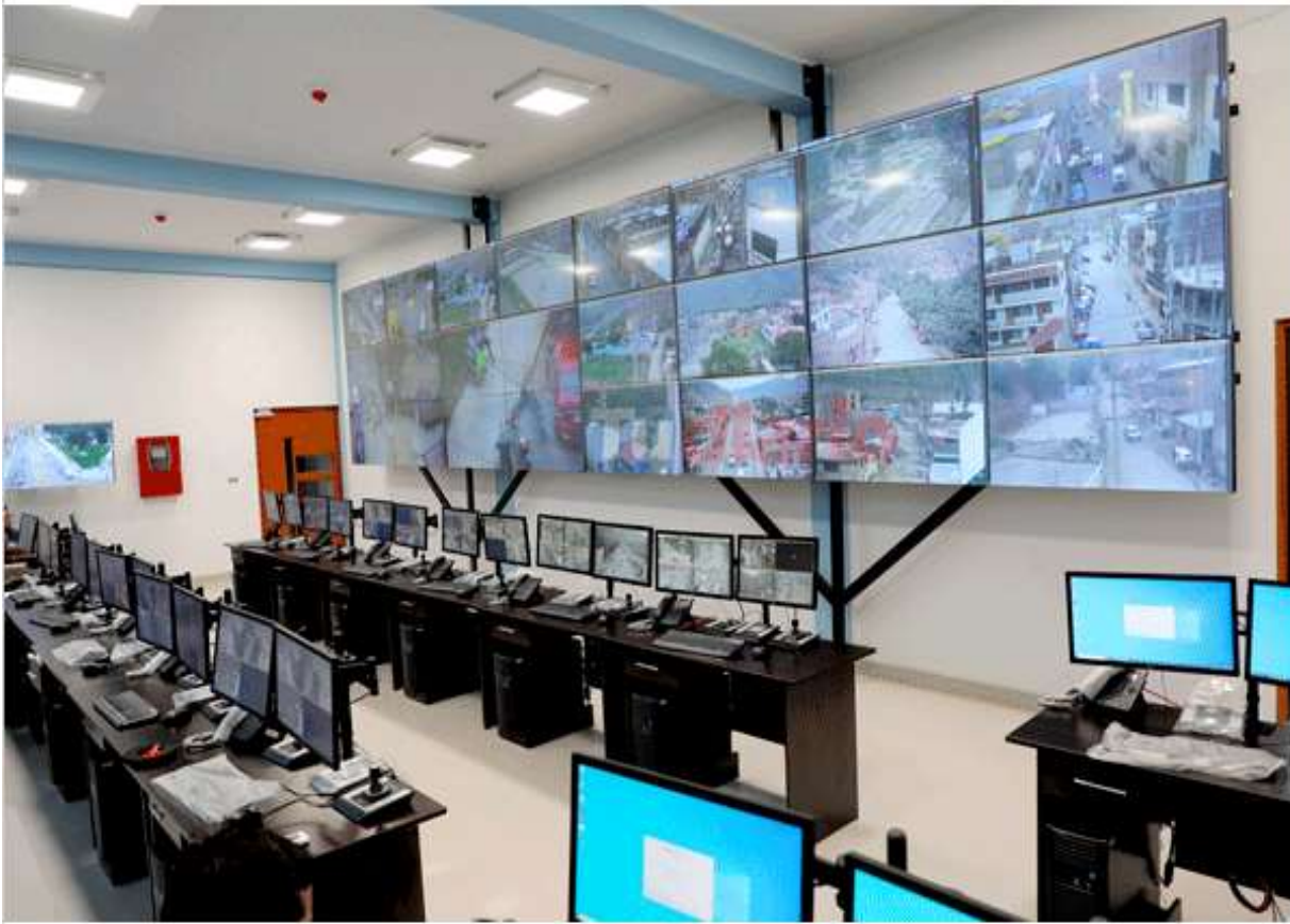
SALA DE MONITOREO Y CONTROL
