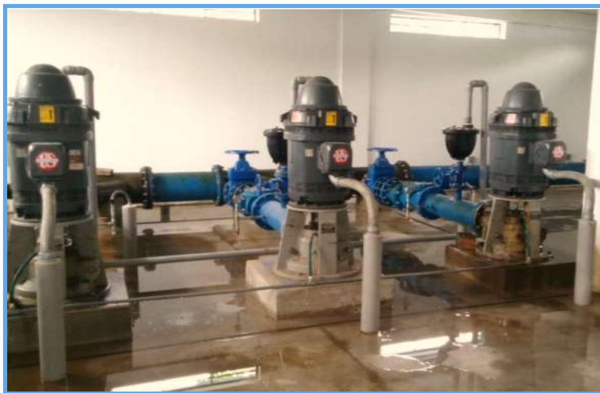
MOTORES DEL TK CISTERNA 500 M3
