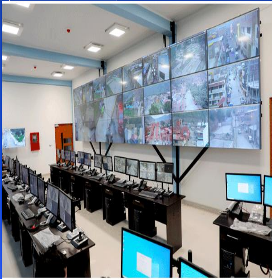
SALA DE MONITOREO Y CONTROL
